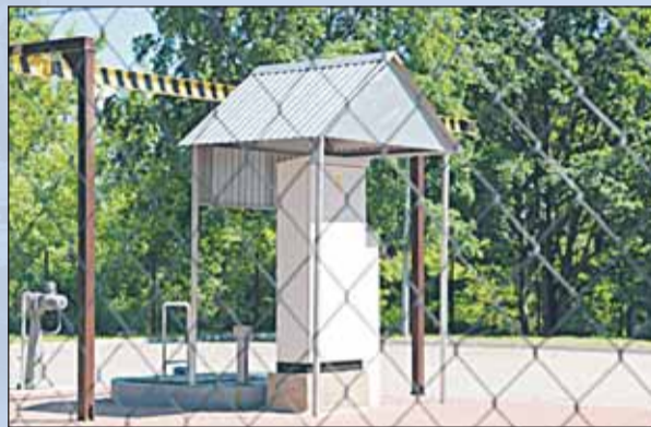
Pompownia PXI-1 w Białobrzegach (2007)
